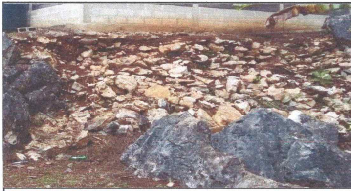
Foto 5: Muro de contencion que pone en riesgo a los estudiantes.
